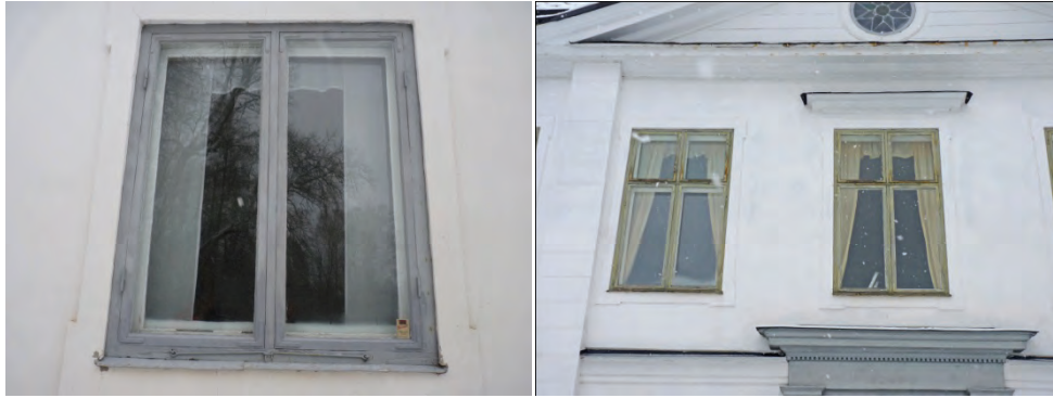
Figur 16. Fönsterbåge i en av pocherna. Kulören på bågarna i nedre våningen är betydligt gråare än i övre våningen. Foto: Helén Sjökvist.
