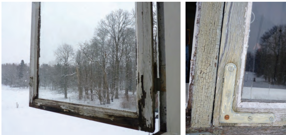
Figur 12. Insida av ytterbåge på östra sidan. Fukt i bottenstycket och omfattande färgbortfall. Foto: Helén Sjökvist.
