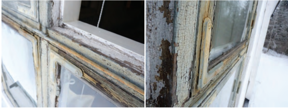
Figur 10. Detalj av fönster på byggnadens östra sida, övre våningen. Rötskador i bågarna. Foto: Helén Sjökvist.
