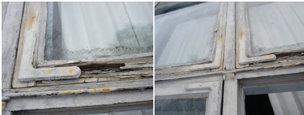
Figur 18. Detalj av omfattande rötskador i fönsterbågen på fönster över västra fasadens entré. Foto: Helén Sjökvist.
