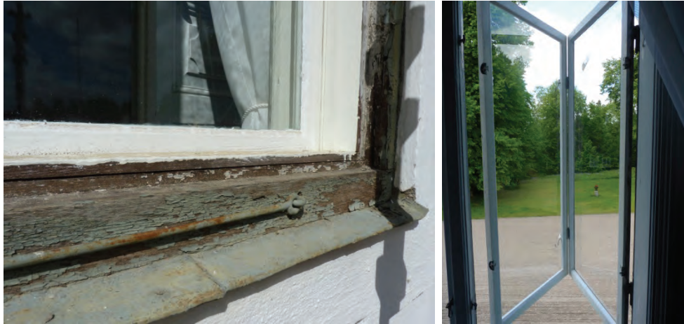
Figur 28. Fönsterbleck i falsad äldre plåt i korta längder, möjligen original. Foto: Helén Sjökvist. Figur 29. De kopplade bågarna har även åtgärdats på mellansidorna. Foto: Helén Sjökvist.
