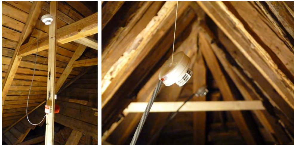
Bild 61. Hissbar rökdetektor på sakristians vind. På den stående regeln där hissordningen är fästad sitter även en siren.
