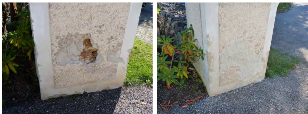
Bild 72. Putsskada på den östra grindstolpen, till följd av påkörning. Bild 73. Skadan putslagad, senare även anfärgad efter kulör på befintlig puts.
