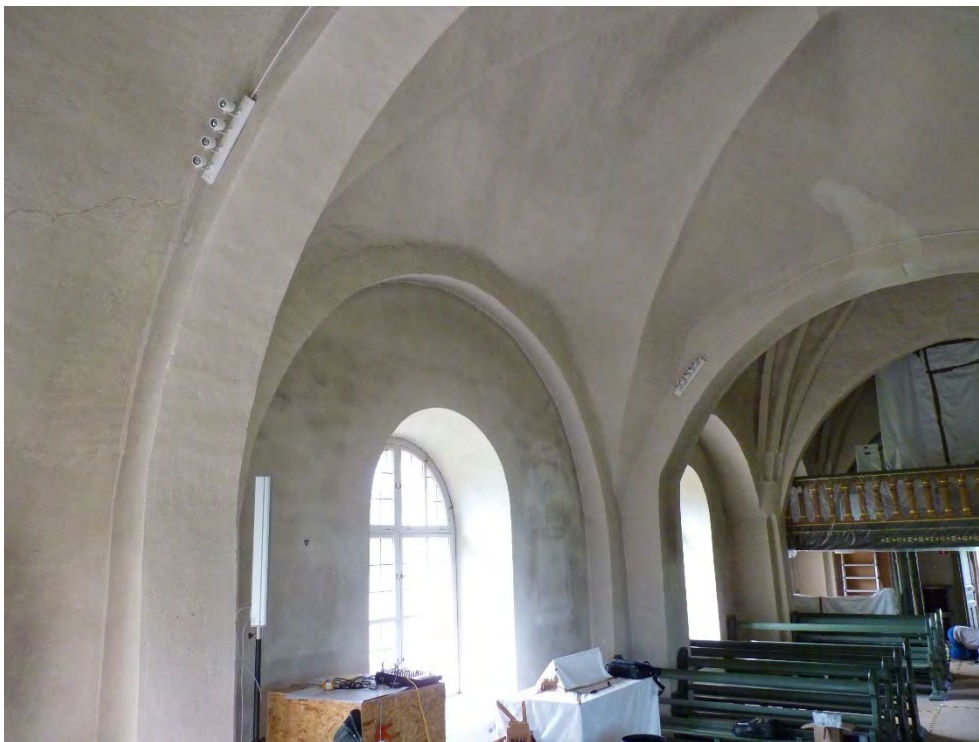
Bild 12. Spotlightsskenor på gördelbågarna, bilden visar den södra väggen från öster.
