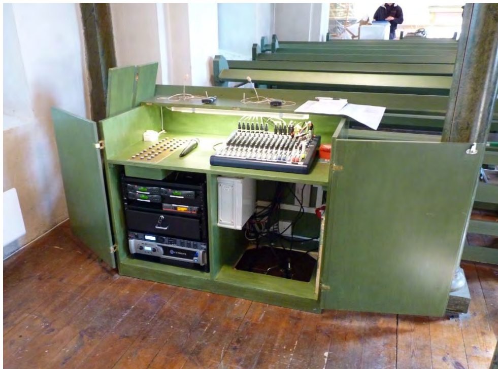
Bild 23. Manöverpulpit för bl.a. styrning av ljudanläggning.
