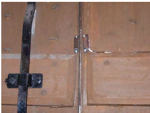
Bild 3. Brytare monterade på entrédörrar.
