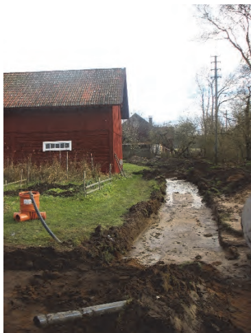
Figur 13. I schakt 4 framkom täckdiken och schaktet fylldes delvis med vatten. Fotograferat från väster av Jonas Ros.
