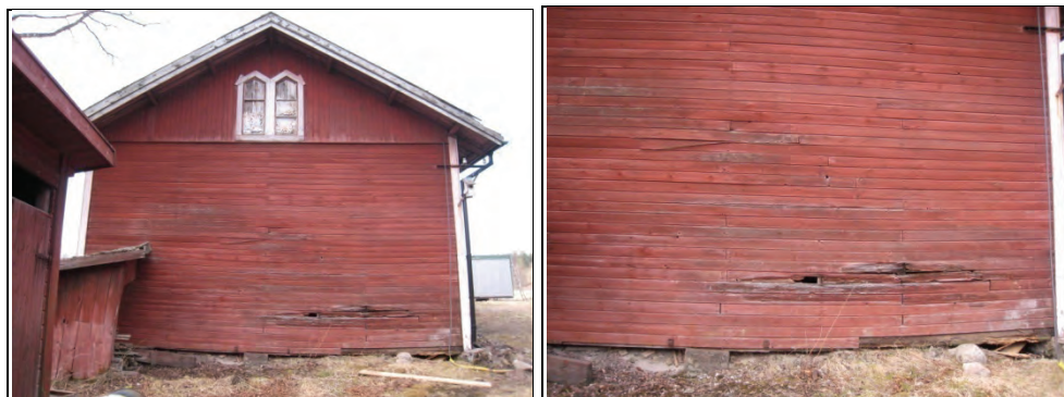
Figur 6. Nordvästra gaveln före åtgärder med rötskador i panel. Foto: Helén Sjökvist.
