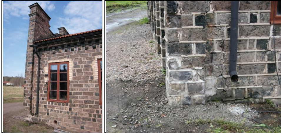
Figur 50. Hörnet på verkstadsbyggnaden har länge haft skador som uppkommit på grund av bland annat snöröjning. Foto: Helén Sjökvist.
