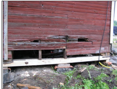
Figur 13. Syllan bytt och stolparna har fästs vid syllan med vinkeljärn. Foto: Helén Sjökvist.
