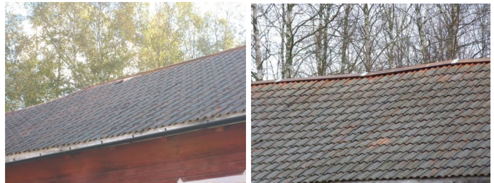
Figur 45. Till vänster i bild syns ett parti där brädnocken saknas. Jämför med figur 42 där samma plats syns från vinden. Foto: Helén Sjökvist.
