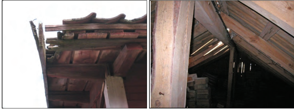
Figur 41. Skadad takfot på byggnadens baksida, södra hörnet. Foto: Helén Sjökvist.
