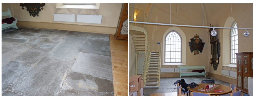
Figur 5. Det gamla kalkstengolv är särskilt bevarandevärt varför infästning av regler måste göras mot trägolvet.
