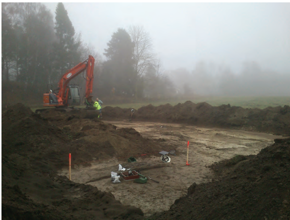
Figur 8. Schaktning i förundersökningsområdets norra del. I förgrunden syns utgrävningen av brandgraven A403. Bakom A403 syns ytterligare en brandgrav, A707. Foto från nordväst av Maud Emanuelsson.
