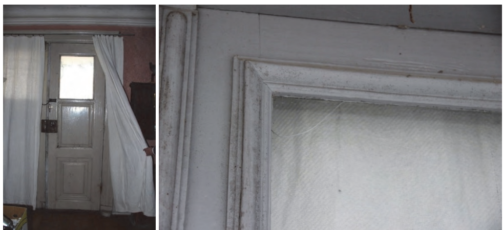
Figur 50. Västra entréns insida har endast rengjorts. Foto: Lisa Skanser.
