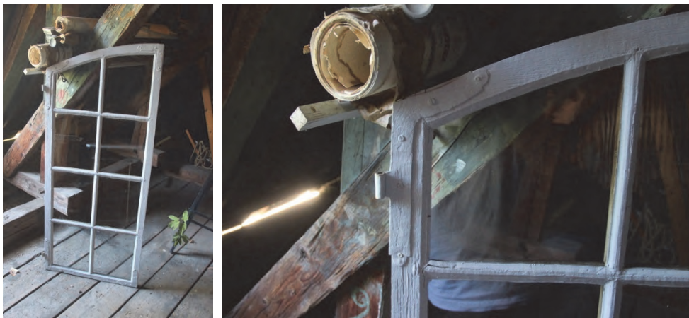
Figur 42. Vindsfönster urplockat men ej åtgärdat. Foto: Lisa Skanser.
