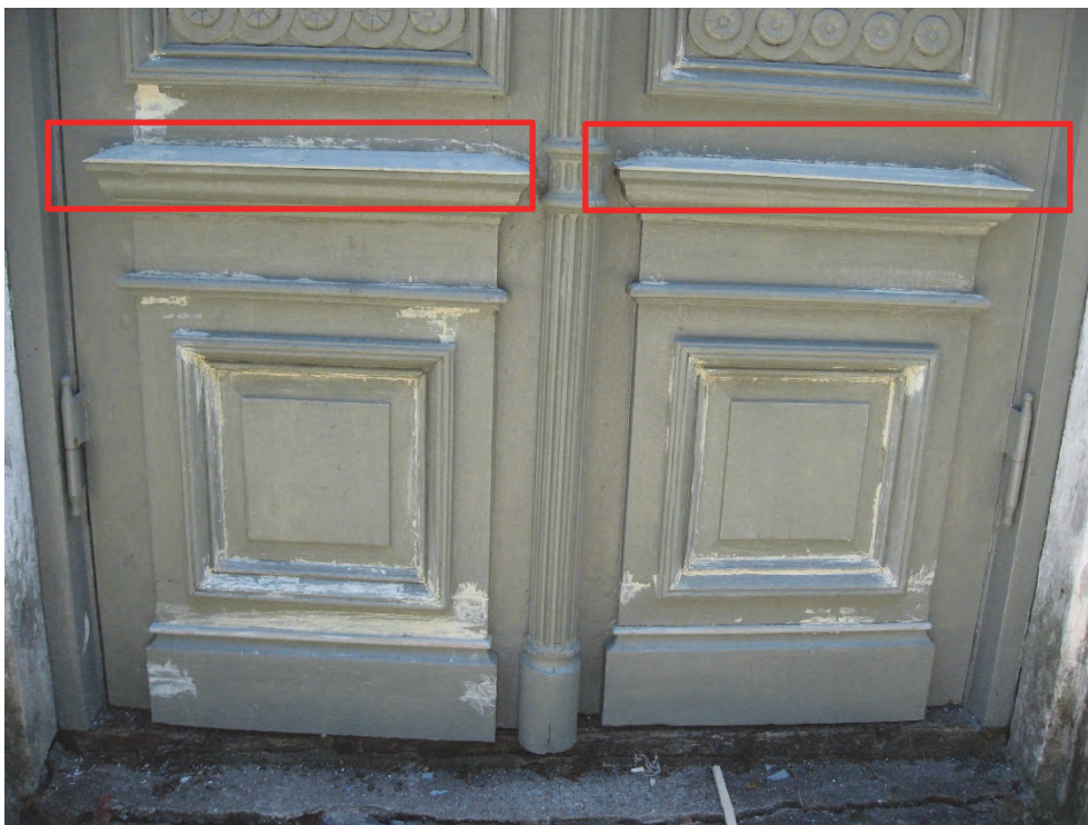
Figur 28. Kittlagningar på dörrblad samt utbytta överliggande lister till spegelparti (markerat). Norra pochens västra entré. Foto: Louise Lorichs/Gunnar Härén.
