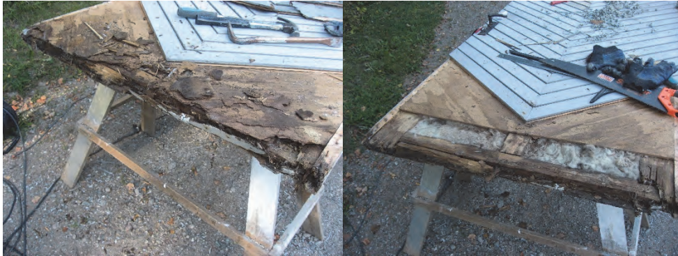
Figur 16. Åtgärdande av skador på ett av södra pochens dörrblad. Foto: Louise Lorichs/Gunnar Härén.
