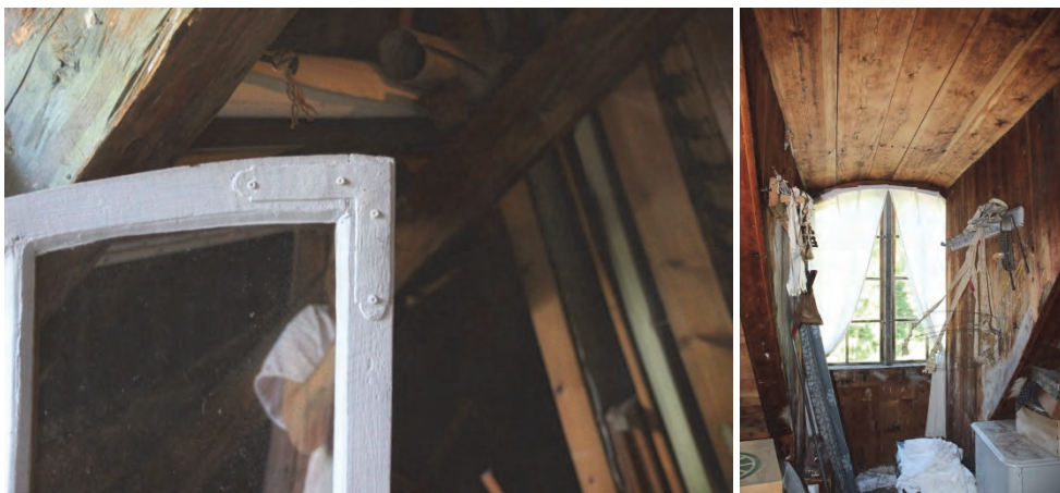
Figur 44. Hörnjärn på vindsfönster innan åtgärd. Foto: Lisa Skanser.
