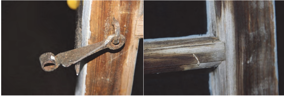
Figur 40. Stormbake på vindsfönster. Fönstrens insida har lämnats omålade. Foto: Lisa Skanser.
