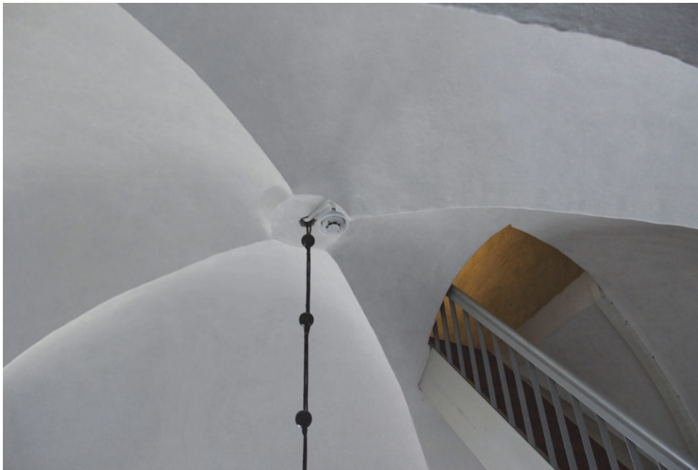
Figur 15. Branddetektor i vapenhuset. Foto: Lisa Skanser.
