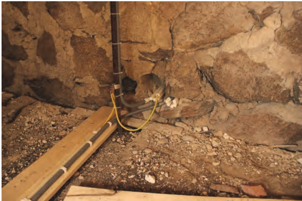
Figur 34. Håltagning och eldragningar mellan torn och vind, samt ny kabelbräda. Foto: Lisa Skanser.
