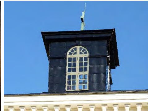
Figur 50. Ommålat lanterninfönster i grön kulör. Foto: Tobias Mårud.
