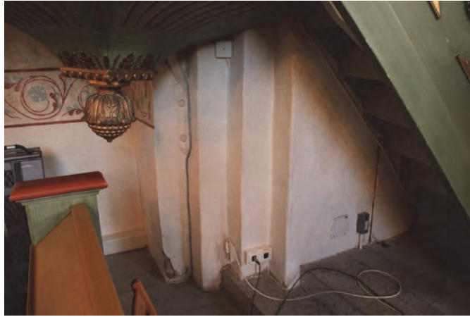
Figur 13. Ny givare placerad under predikstolstrappa. Foto: Lisa Skanser.
