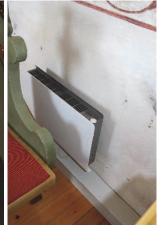
Figur 14. Ny konvektor på långhusväggen, sedd från sidan. Foto: Helén Sjökvist.
