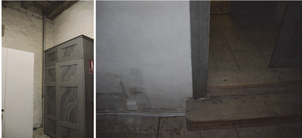
Figur 28. Tidigare kabelbräda kompletterad med nya kablar. Foto: Lisa Skanser.
