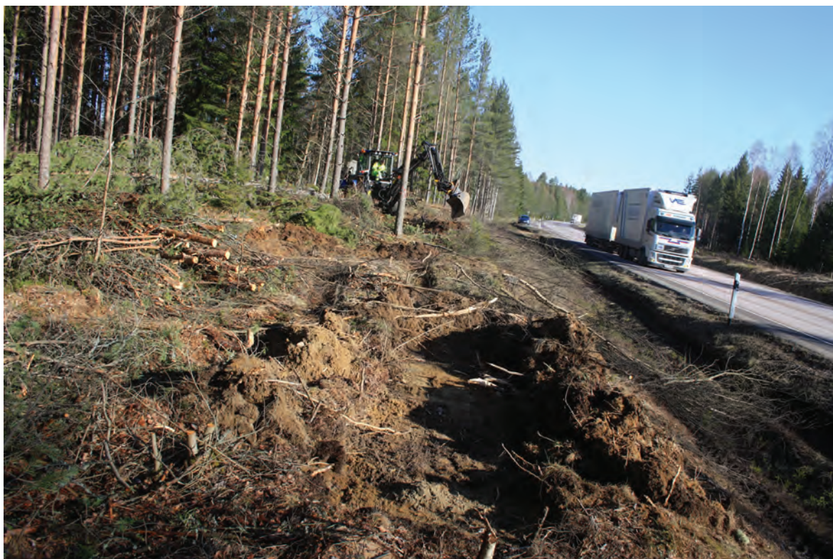
Figur 3. Schakt i väggkanten på objekt 19. Inom själva vägområdet hade skogen avverkats och en del rishögar låg kvar. Vy från söder med passerande trafik på riksvägen. Foto: Jenny Holm.
