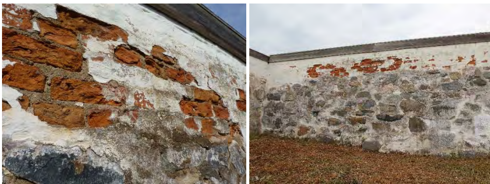
Figur 10. Detalj av frostsprängt/vittrat tegel.
