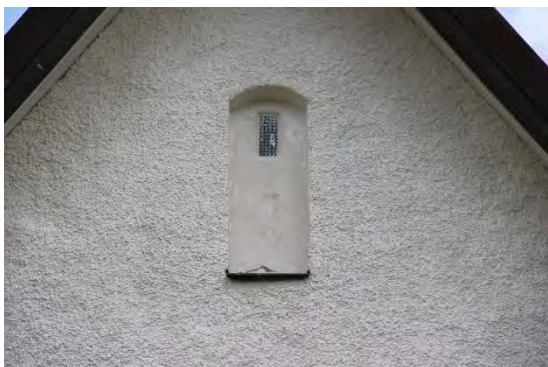
Figur 29. Blindering i västra gavelröset som inte åtgärdats. Foto: Tobias Mårud.
