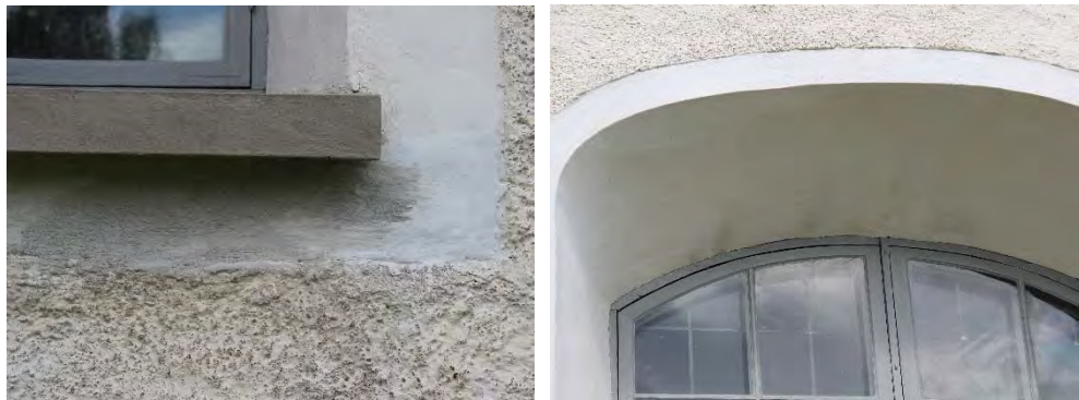
Figur 41. Omålad bättringslagning under sakristians fönster. Foto: Tobias Mårud.
