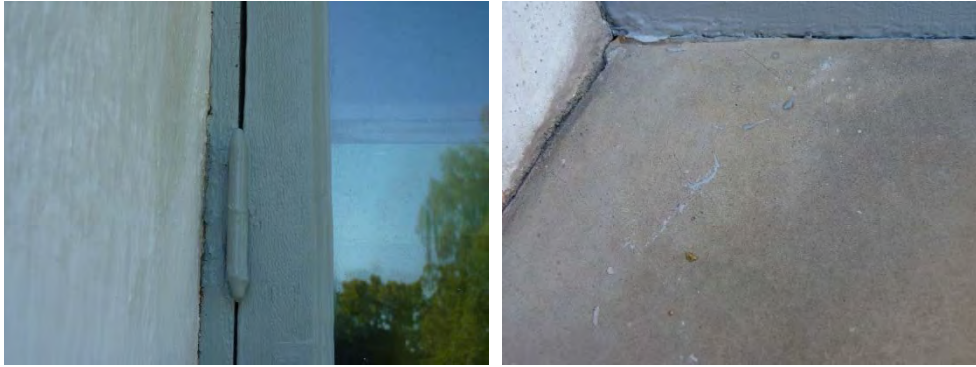
Figur 24. Då bågarerna är fastskruvade målades de stängda, med bl.a. hopmålade gångjärn som följd. Foto: Tobias Mårud.
