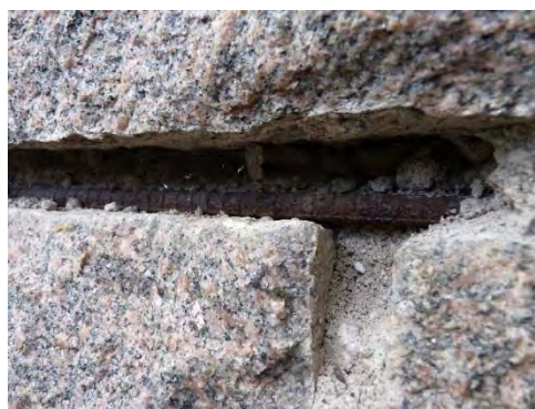
Figur 7. Detalj av murverket med blottlagt armeringsjärn. Foto: Tobias Mårud.
