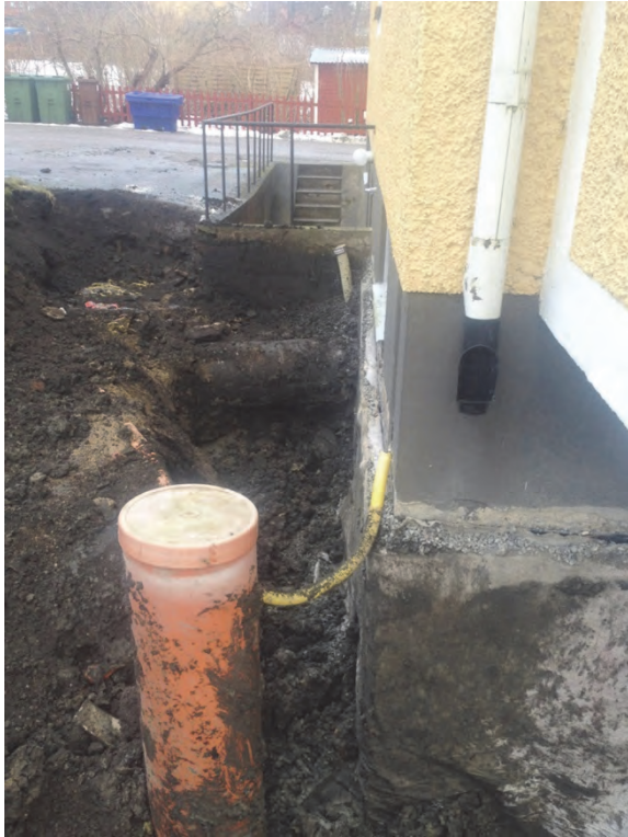
Figur 4. Översikt över schaktet där sektion 2 (se bilaga 1) upprättades på den norra sidan av huset. Fotograferat från väster av Jimmy Abrahamsson, Svensk Entreprenadteknik SET AB.
