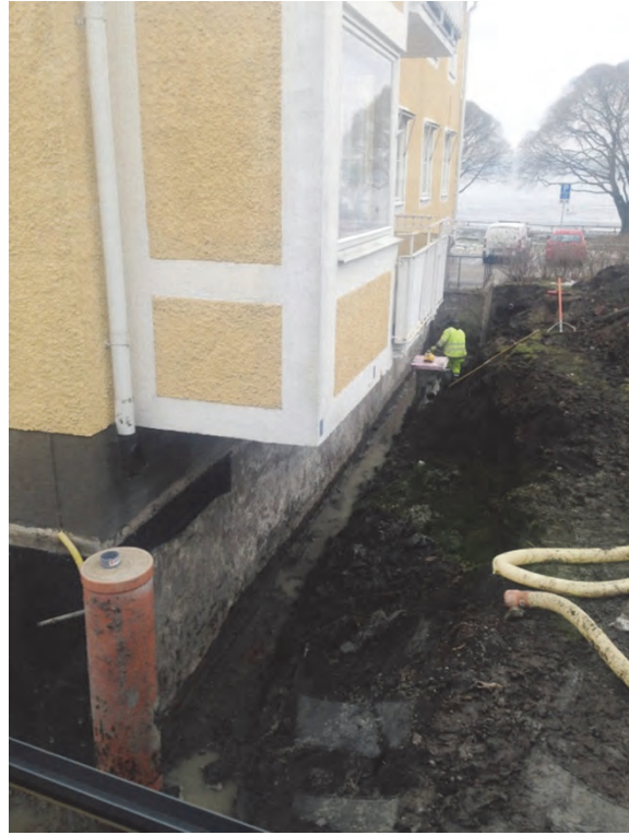
Figur 5. Översikt över schaktet, med sektion 1 (se bilaga 2), på den västra sidan av huset. Fotograferat från norr av Jimmy Abrahamsson, Svensk Entreprenadteknik SET AB.
