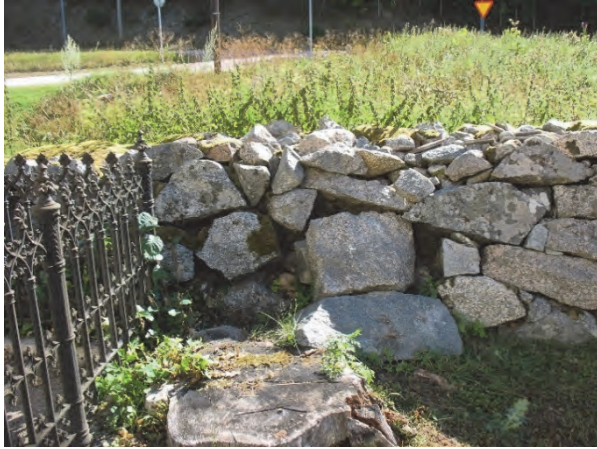
Figur 9. Fotografi som visar det skadade partiet av kyrkogårdsmuren (jfr. figur 8). Fotograferat från väster av Jonas Ros.
