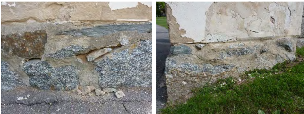
Figur 14 & 15. Socklarna till grindstolparna uppvisade sprickor och skador i den cementhaltiga fogstrykningen. Foto: Tobias Mårud.
