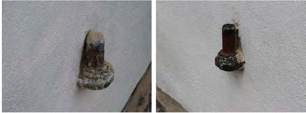
Figur 30 & 31. Grindhakarna är obrukbara då putsen ligger för nära. Bilderna visar ett av haken efter åtgärd i rengjort (höger bild) respektive icke rengjort skick (vänster bild). Foto: Tobias Mårud.
