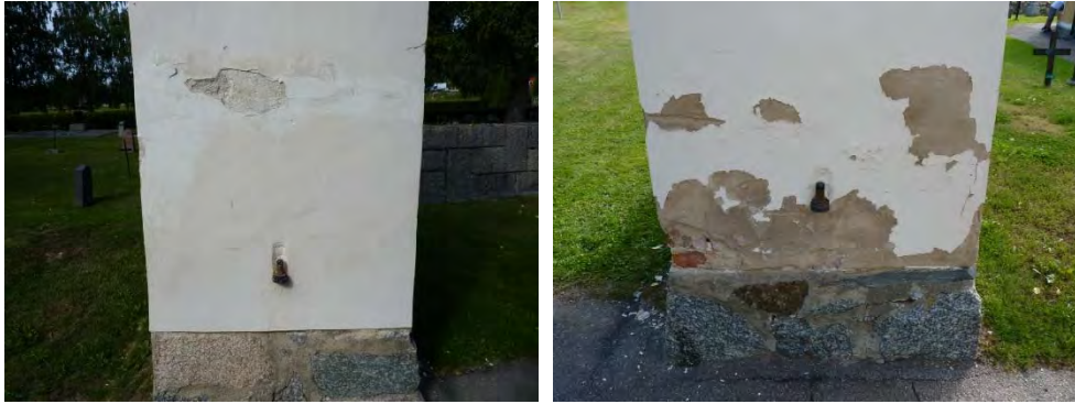
Figur 12 & 13. Grindstolparnas fasader in mot passagen är utsatta för mekaniskskada. Foto: Tobias Mårud.
