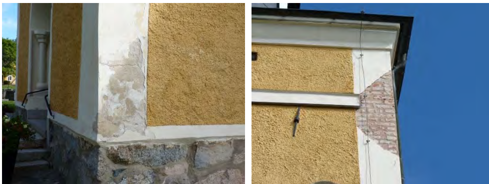
Figur 16 & 17. De två mest omfattande skadorna på kyrkofasaden var på vapenhusets sydvästra hörn samt på östra delen av södra fasaden på tornets klockvåning. Foto: Tobias Mårud.
