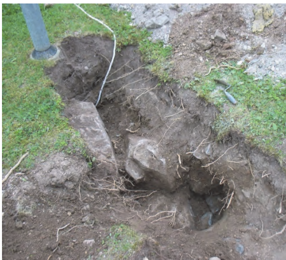
Figur 20. Stenarna i schakt 2 som bedöms kunna vara grundläggning till en klockstapel. Fotograferat från sydöst av Jonas Ros.
