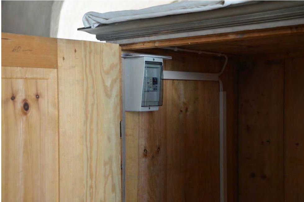
Figur 18. Reglaget för klimatstyrningen är placerat i ett av de äldre skåpen. Foto: Tobias Mårud.
