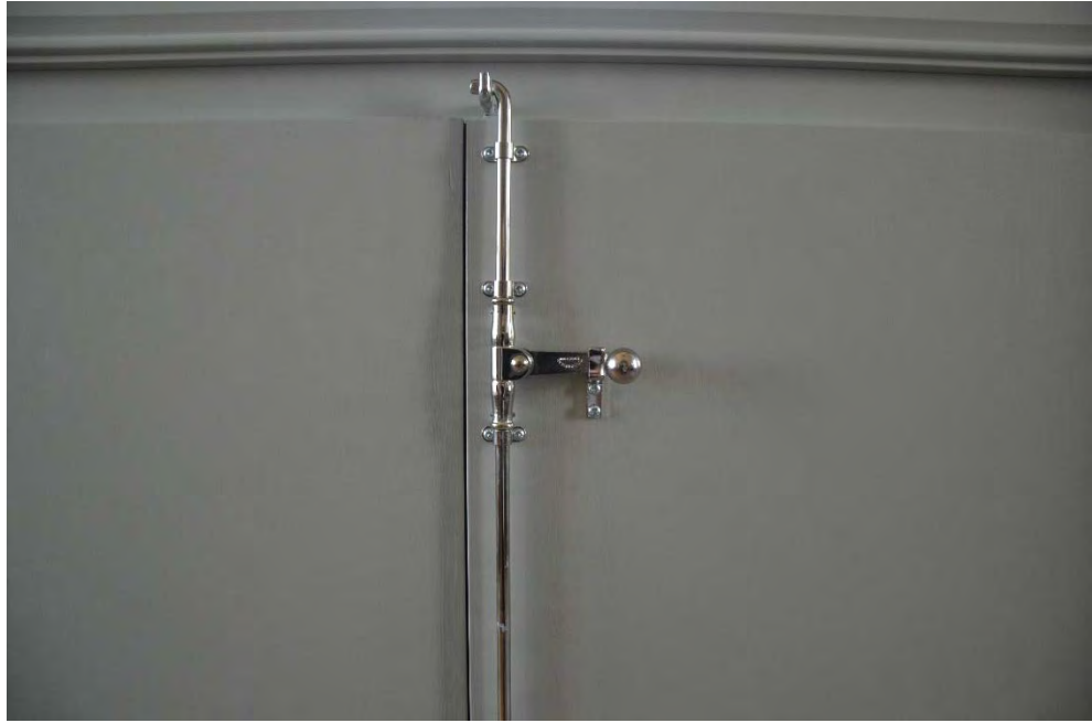
Figur 16. Utvärdig spanjolett för öppning och reglering av dörrarna. Foto: Tobias Mårud.
