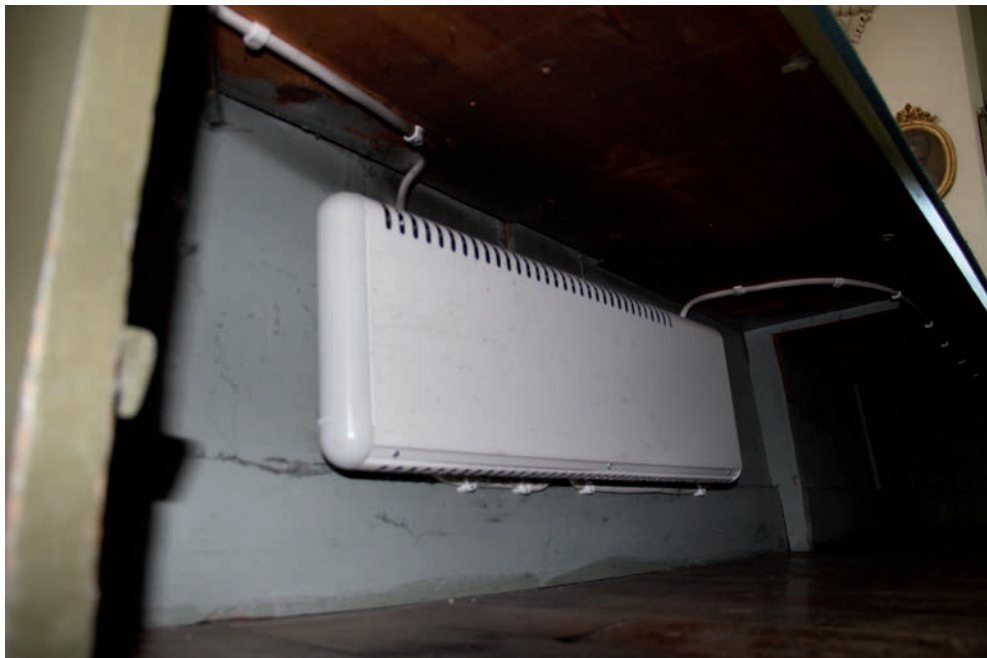
Figur 10. Både här och i figur 9 framgår svärtningen ovanför radiatorerna. Foto: Tobias Mårud.
