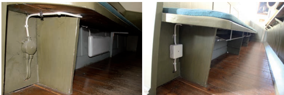
Figur 11. Vid den tidigare kabeldragningen återanvändes äldre ledningar och dosor... Foto: Tobias Mårud.
