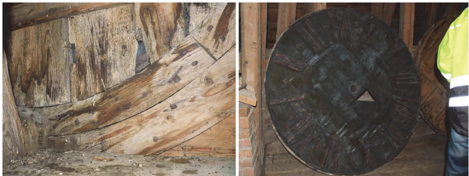
Figur 11. Skador i urtavlans stomme före åtgärder. Foto: Herbert Sandner.
