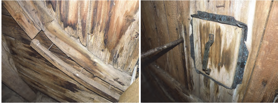
Figur 9. Skador i träkonstruktionen före åtgärder. Foto: Herbert Sandner.
