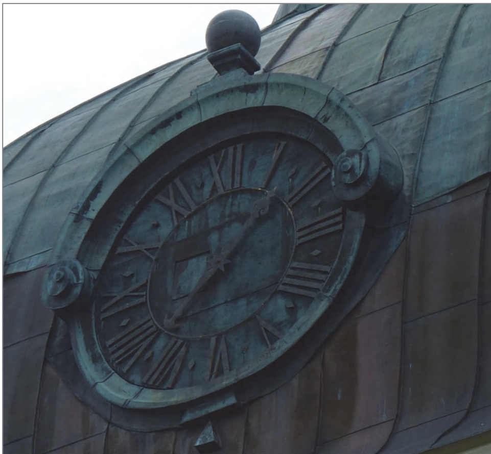
Figur 6. Urtavlorna före renovering. Urtavlan kröns av kopparklädd kula, monterad på en piedestal. Under urtavlan sitter trekantiga guttaedroppar varav flera saknades. Mellan de romerska siffrorna sitter romber av mässing. Foto: Helén Sjökvist 2010.
