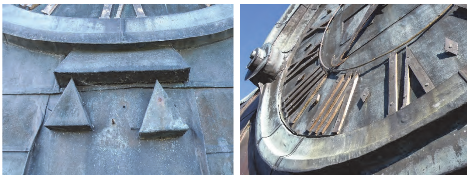
Figur 7. Guttaedropparna saknas delvis eller sitter löst. Spikbål efter tidigare droppar gör att det finns risk för vatteninträning. Foto: Herbert Sandner.
