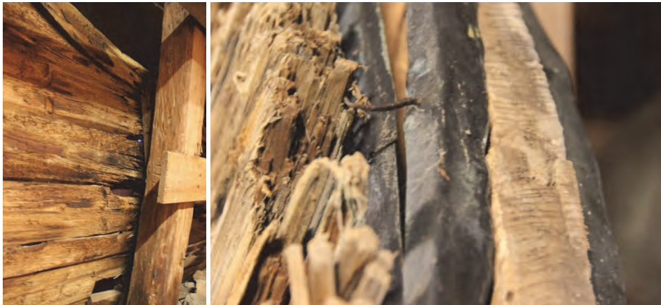
Figur 27. Rötskador i panelen under södra urtavlan. Foto: Lisa Skanser. Foto: Lisa Skanser.
