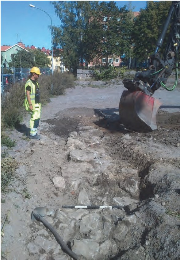
Figur 16. Duncan Alexander övervakar framgrävning av en busgrund från 1800–1900-tal i schakt 11. I bakgrunden ses muren som avgränsade den norra från den södra delen av undersökningsområdet. Fotograferat av Jonas Ros från söder.
