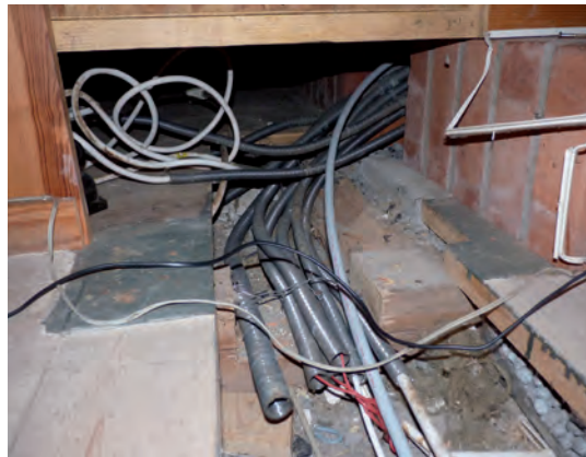
Figur 16. Befintliga kabelrör under orgel och västra delen av långhuset (övre bilden). Foto: Tobias Mårud.
