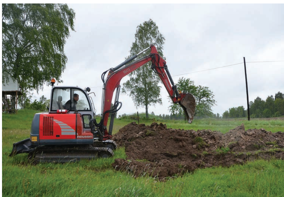
Figur 2. Översikt över påbörjat schaktningsarbete i ledningssträckans östliga del. Under grävmaskinens arm samt till höger om skopan syns två skärvstenshögar i den intilliggande åkermarken, Västerås 782:1-2. Fotograferat från söder av Maud Emanuelsson.
