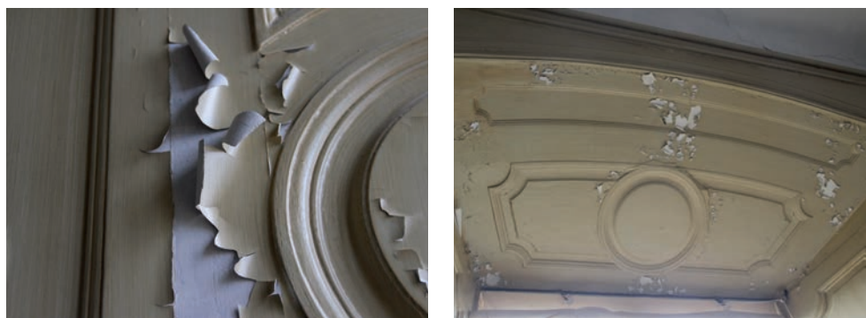
Figur 4. Kraftigt flagande färg i fönsternisch. Foto: Lisa Skanser.
