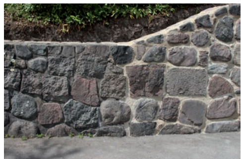
Figur 22. Skarven mellan den restaurerade delen och den icke åtgärdade. Foto: Tobias Mårud.
