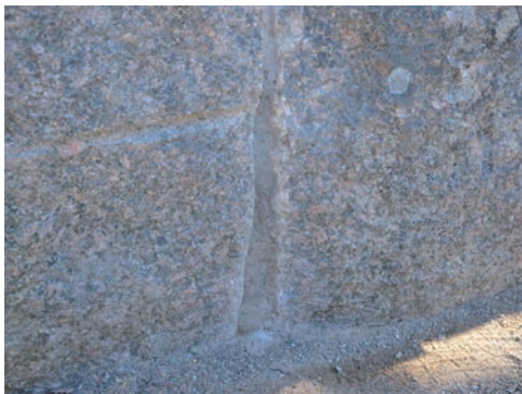
Figur 31. Del av åtgärdad mur, med bruk och bearbetad sten. Foto: Tobias Mårud.
