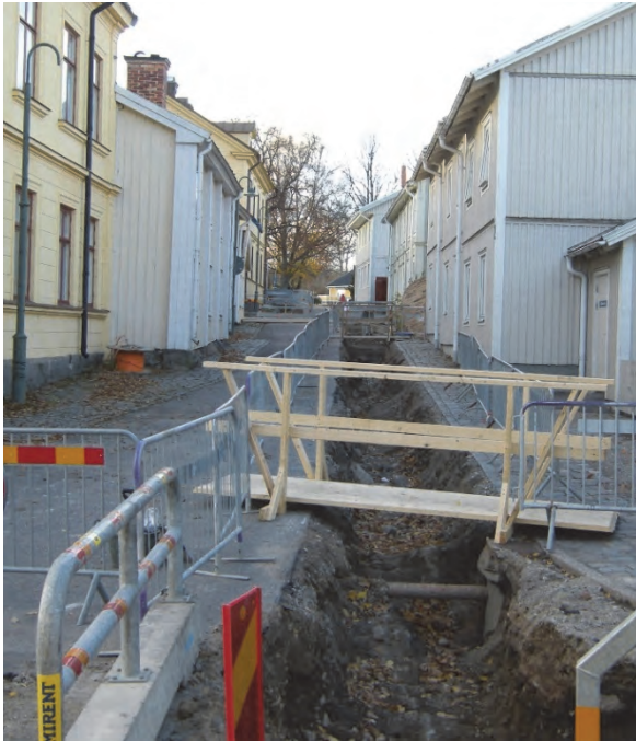
Figur 13. Översiktssbild som visar schaktet i Järnvägsgatan. Fotograferat från öster av Jonas Ros.
