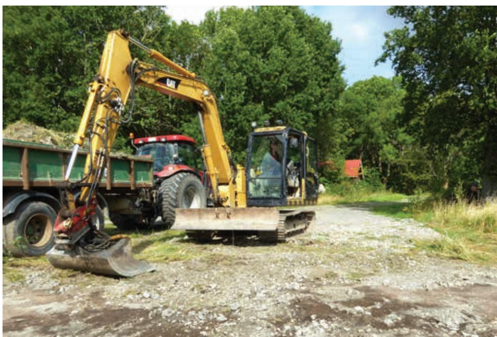
Figur 8. På den mindre, hårdgjorda ytan intill grusvägen ligger ett gruslager (ca 6 x 4 m) som enligt Gräscenter AB har lämnats där någon gång efter våren 2015 av annan utförare. Detta gruslager överlagrar nu det upp till 0,20 meter tjocka stenkrossmaterialet som ändå ska ligga kvar. Fotograferat från söder av Maud Emanuelsson.
