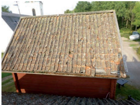
Figur 35. Östra takfallet innan åtgärd. Foto: Johan Stråhle.
