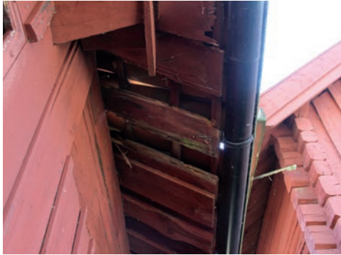
Figur 27. Rötskada i västra takfallets takfot. Foto: Tobias Mårud.
