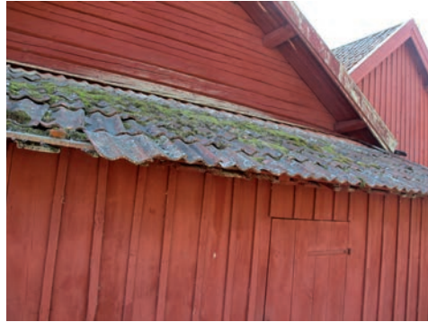
Figur 28. Takpannor saknades på taket till dasset. Foto: Tobias Mårud.
