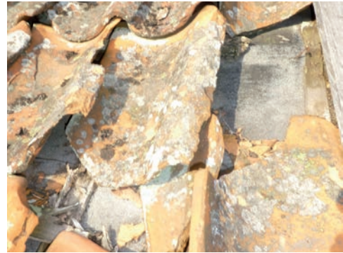
Figur 36. Pappan exponerad och takpannor i dåligt skick. Foto: Johan Stråhle.
