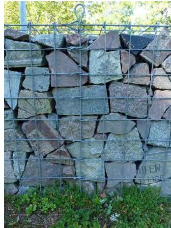
Figur 8. Fyllningen i gabionmuren har plockats och anpassats för att undvika sättningar. Foto: Helén Sjökvist
