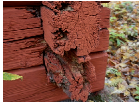
Figur 71. Delar av timret uppvisar tidigare skador, här en knutskalle i dålig kondition. Foto: Tobias Mårud
