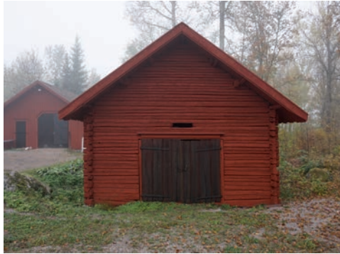
Figur 78. Sydöstra gaveln efter åtgärd. Foto: Tobias Mårud.
