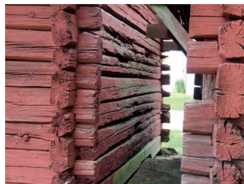
Figur 8. Norra gavelns timmer är skadat av vatten från taket på intilliggande byggnad 2. Foto: Tobias Mårud.
