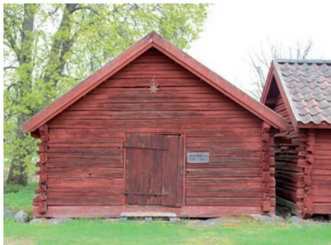
Figur 17. Västra gaveln innan åtgärd. Foto: Tobias Mårud.
