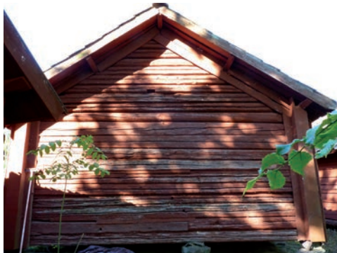
Figur 54. Östra gaveln innan åtgärd. Foto: Helén Sjökrist.
