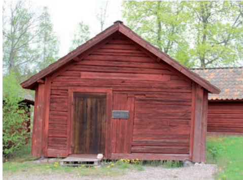
Figur 52. Västra gaveln innan åtgärd. Foto: Tobias Mårud.
