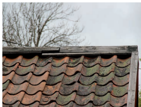
Figur 22. Östra delen av södra takfallet innan åtgärd. Foto: Tobias Mårud.
