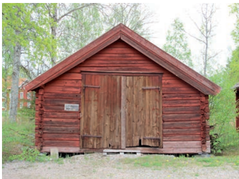
Figur 62. Västra gaveln innan åtgärd. Foto: Tobias Mårud.
