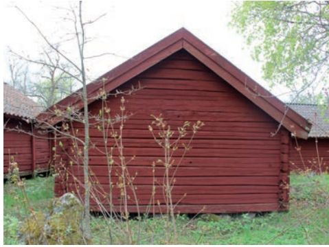
Figur 64. Östra gaveln innan åtgärd. Foto: Tobias Mårud.
