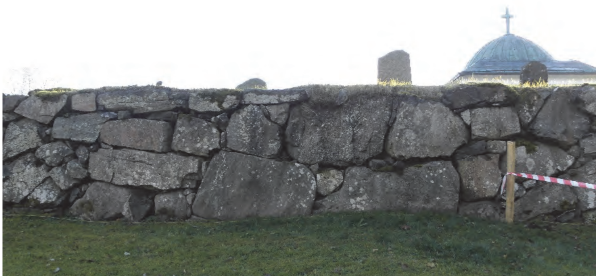
Figur 6. Detalj av den medeltida byggnadens västra mur. De större stenarna representerar läget för en igensatt öppning (jfr sektion 5, figur 12). I bakgrunden ses delar av Rosenholmska gravkapellet. Fotograferat från väster av Jonas Ros.
