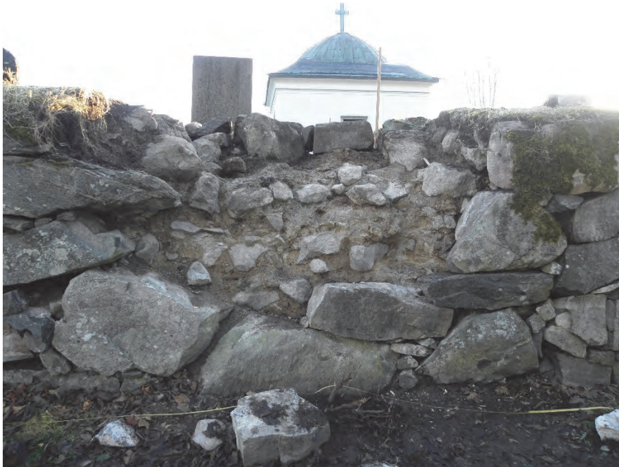
Figur 13. I den västra muren fanns det en skada (jfr figur 12). Murens kärna var mycket hård. I förgrunden ses murens yttremantel. I bakgrunden ses delar av Rosenholmska gravkapellet. Fotograferat från väster av Jonas Ros.
