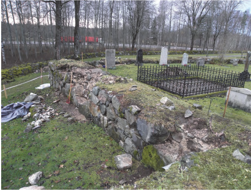
Figur 17. Översikt över den södra muren. Det fanns två skador i muren. I bakgrunden ses väg E20. Fotograferat från sydväst av Jonas Ros.
