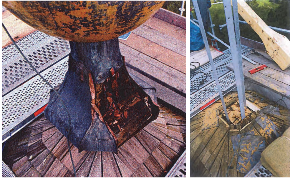
Figur 67. Rötskador i korsstock som uppkommit på grund av läckage. Foto: AJAB Tak och fasadkonsult AB.
