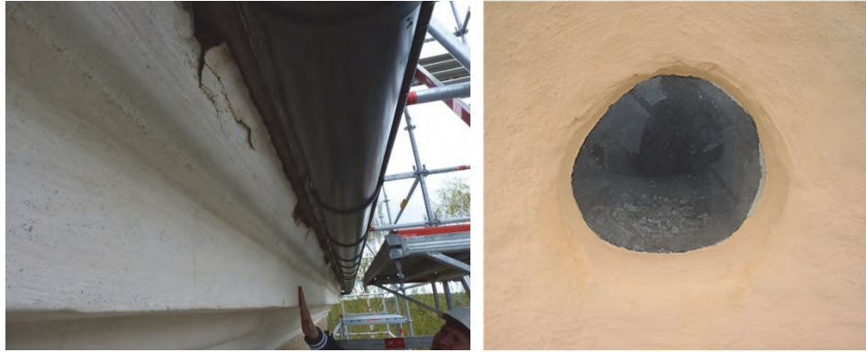
Figur 22. Sprickor och putssläpp i torngesimsen. Foto: Helén Sjökvist.
