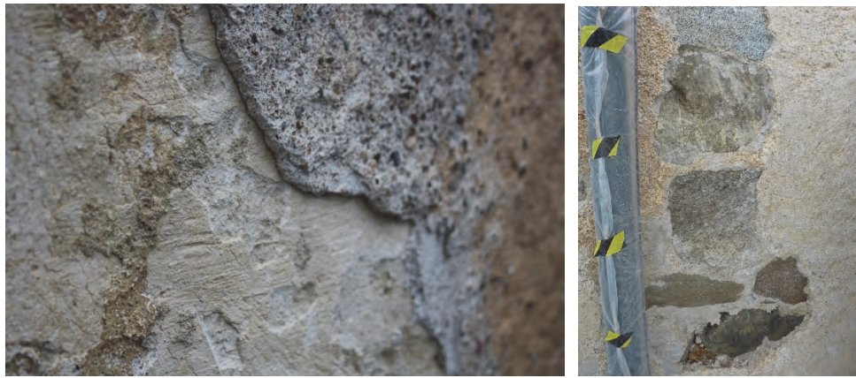
Figur 15. Putsen från 1979-års renovering ligger som ett tunt skikt på den äldre, fetare och slätare putsen. Foto från vapenhusets västvägg. Foto: Helén Sjökvist.
