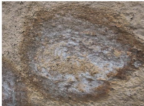
Figur 13. Möjlig saltutfällning på östra fasadens nedre del. Foto: Helén Sjökvist.
