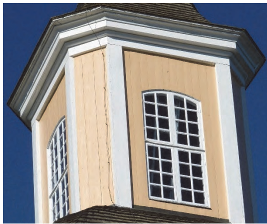
Figur 39. Ommålad lanternin sedd från sydväst. Foto: Helén Sjökvist.
