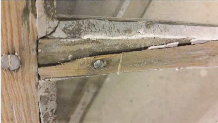
Figur 34. Sprickor i virke på båge 3:1 enligt Miljönärens märkning. Foto: Miljönären.
