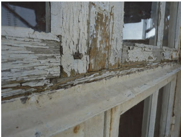
Figur 30. Fönsterbåge mot väster med utkrypande plugg. Foto: Helén Sjökvist.
