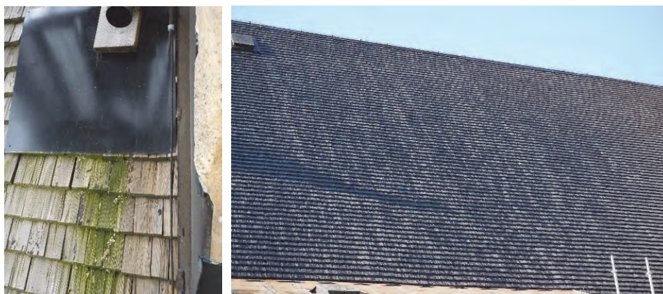
Figur 78. Där vatten runnit från tornets takavvattning ned på spåntaket fanns i synnerhet på norra sidan tydlig algpåväxt. Foto: Helén Sjökvist.
