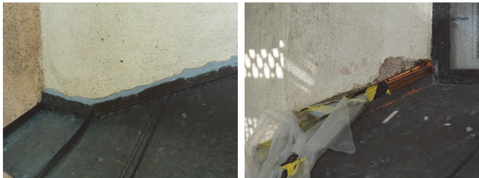
Figur 61. Fönster på tornets sydfasad. Tidigare tätning mellan puts och solbänk med tätningsmassa. Foto: Helén Sjökvist.
