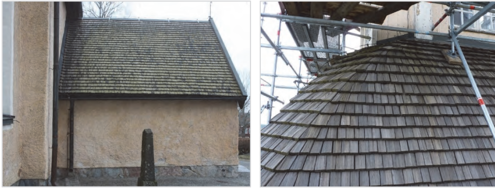
Figur 80. Vapenhusets tak före omtjärning. Foto: Helén Sjökvist.
