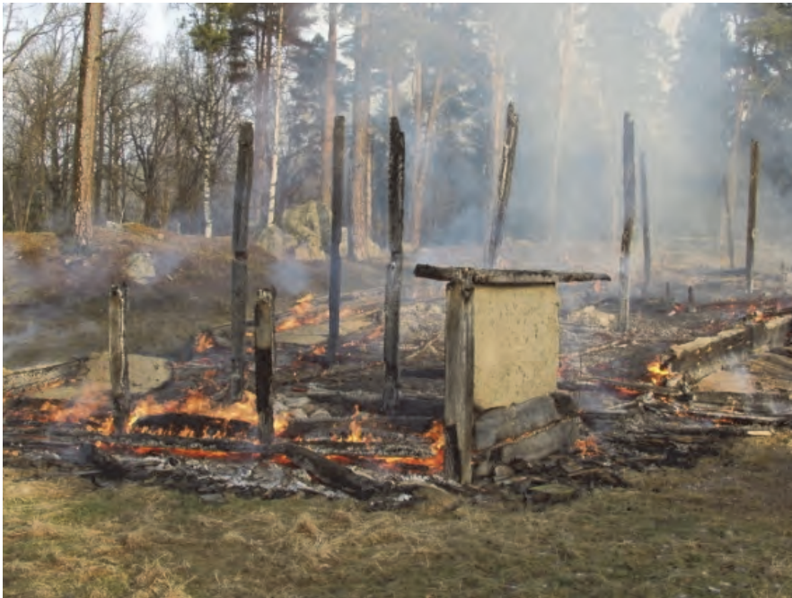
Figur 8. Taket och väggarna brann upp, vissa sektioner av väggarnas ramverk rasade, men som ses på bilden stod några sektioner kvar efter branden. De flesta av de inre takbärande stolparna stod upp efter branden. Till höger ses att de kraftiga syllstockarna var eldpåverkade. Fotograf Karin Nordström, Västmanlands läns Museum.
