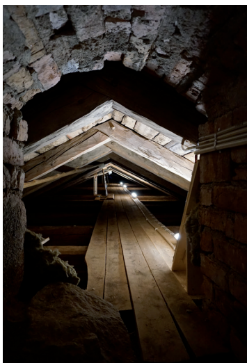
Bild 23 (överst till vänster). Tidigare armaturer på vind var monterade på kabelbräda i tak. Foto: Tobias Mårud.
