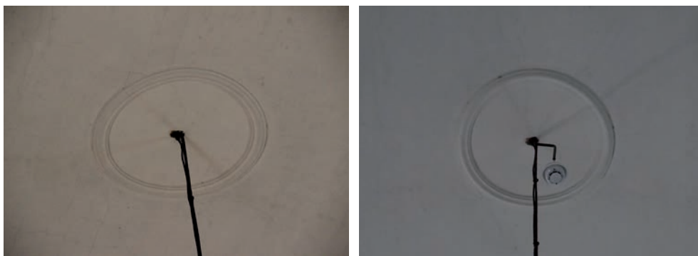
Bild 47. Detektorer monterades i anslutning till ljuskronornas pendlare. Genomförning gjordes i befintlig öppning. Bilden visar öppningen innan åtgärd. Foto: Tobias Mårud.
