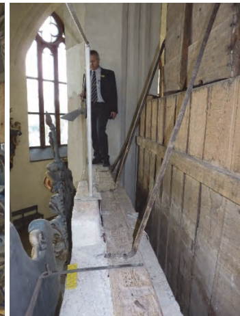
Figur 13. Nya infästningar görs på två ställen i den inmurade bjälken. Foto: Helén Sjökvist.
