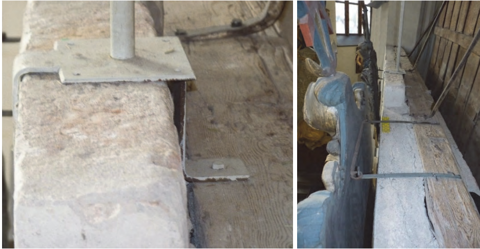
Figur 14. Gammal infästning av befintligt räcke. Foto: Helén Sjökvist.
