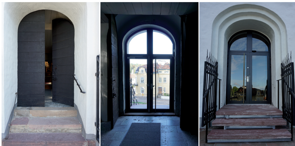
Figur 40. Västra entréns port innan åtgärd. Foto: Tobias Mårud.
