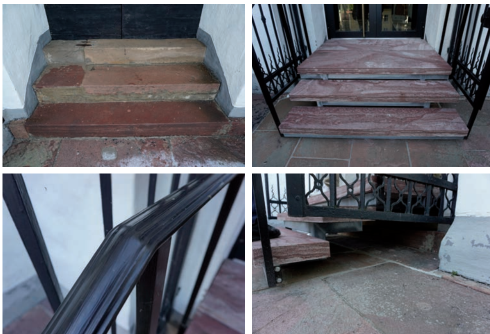
Figur 36. Den översta delen av trappan, upp mot porten, innan åtgärd. Foto: Tobias Mårud.
