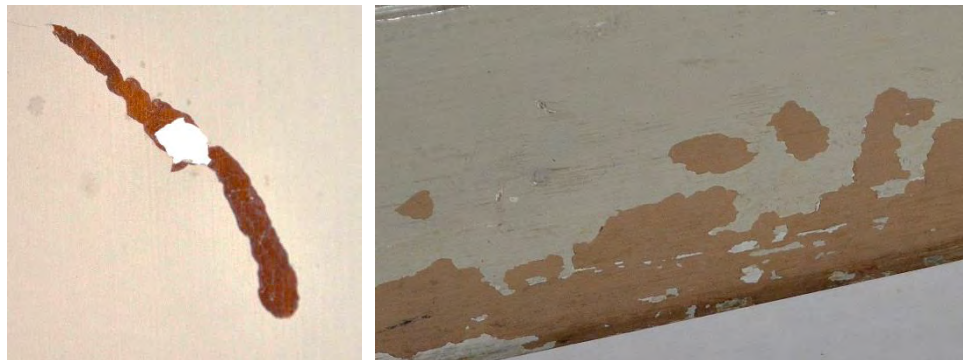
Figur 9. Spår av mabognyfärgad yta under nuvarande gråa kulör på dörrsidorna ute i trapphuset. Foto Helén Sjökvist.
