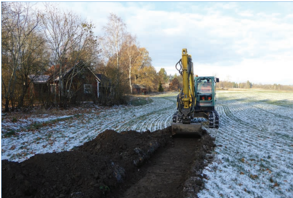
Figur 3. Schaktning i snöiga förhållanden vid objekt KM183. I bakgrunden ser man den bebyggelse och skog som finns inom området. Foto Karolina Karlsson.
