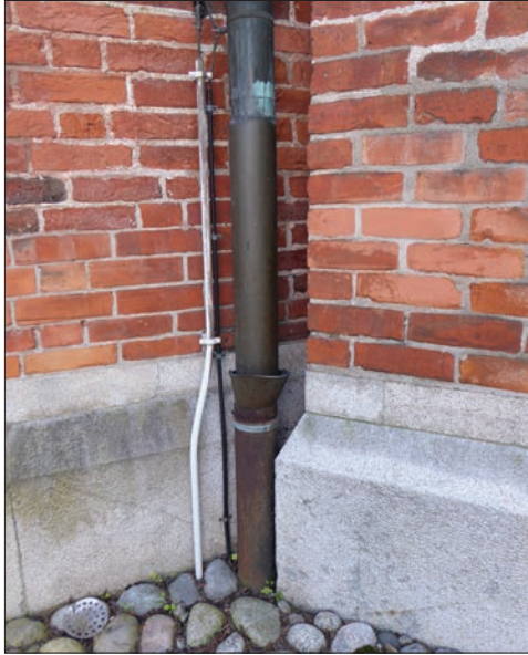
Figur 3. De äldre anslutningarna mot gjutjärnsrören var utformade som en trutt med en sil i botten.
