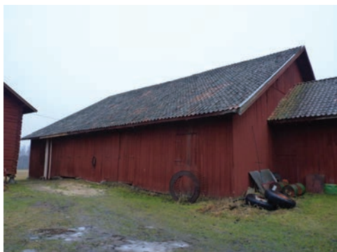
Figur 17. Östra takfallet innan åtgärd. Foto Tobias Mårud.
