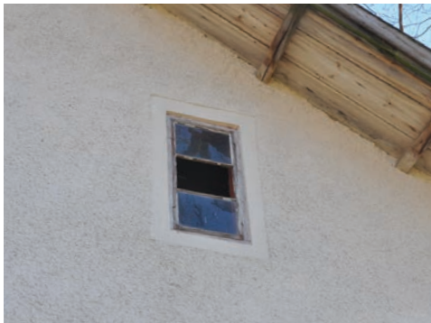
Figur 13. Ett av fönstren innan ... Foto Tobias Mårud.
