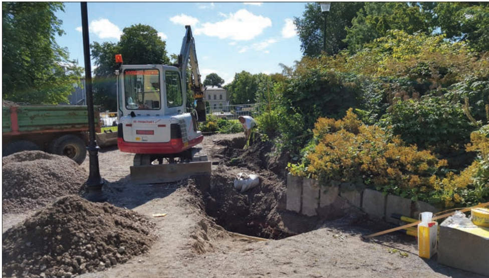
Figur 10. Schakt 3. I bakgrunden schaktas för ny elkabel. Foto från nordväst av Maud Emanuelsson.
