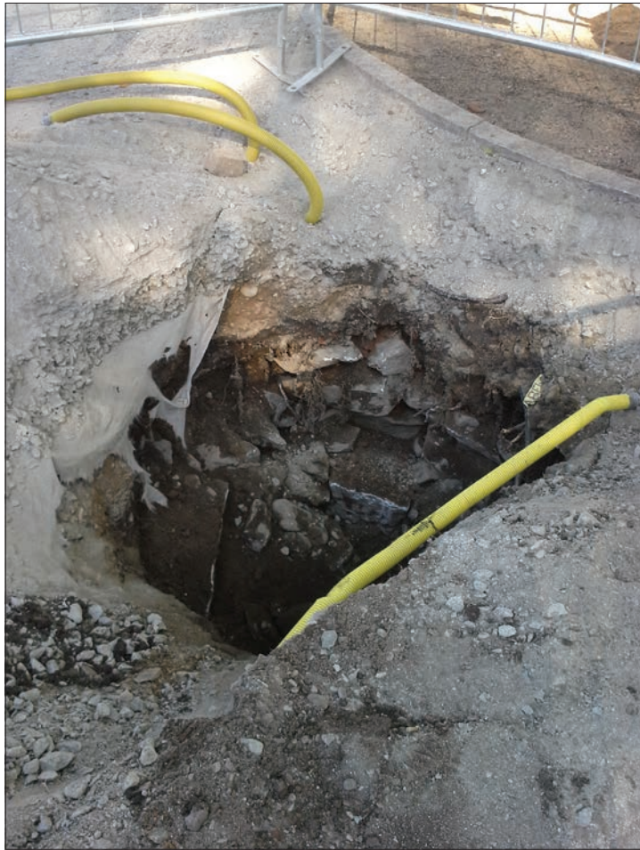
Figur 14. Påförd sprängsten syns här i schakt 5. Foto från söder av Jonas Ros.
