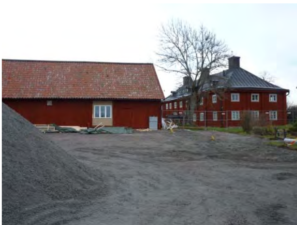
Figur 14. Aktuellt område sett mot norr under pågående markarbeten. Nytt fönster upptaget på bus 11. Foto. Helén Sjökvist.
