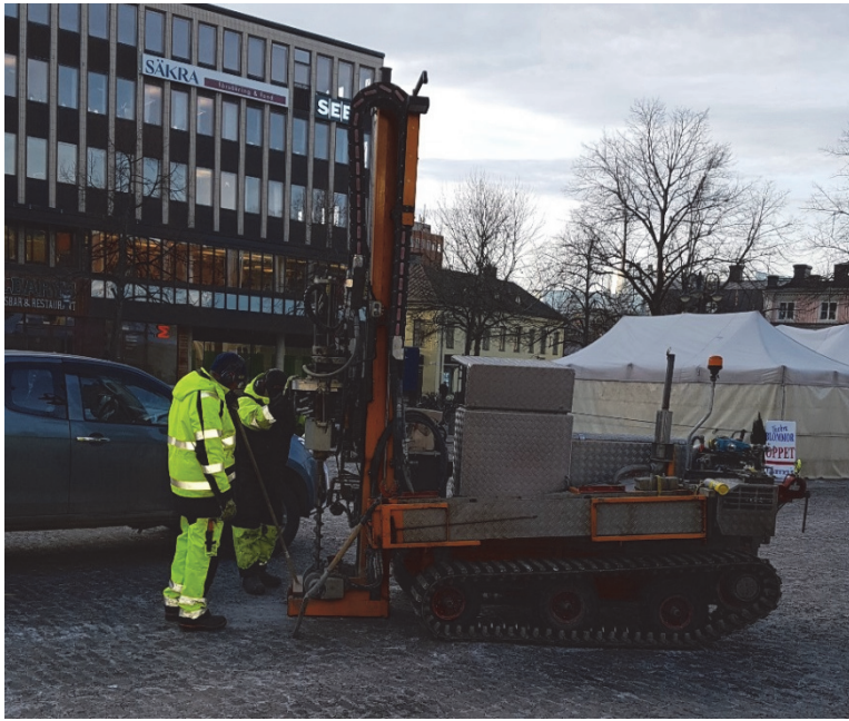
Figur 4. Hålen på Stora Torget borrades med hjälp av en borrbandvagn. Foto från sydväst av Jonas Ros.
