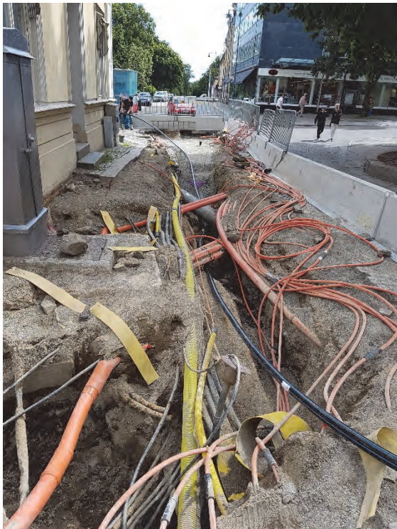
Figur 6. I det upptagna schaktet i Slottsgatan framkom ett mycket stort antal ledningar som försvarade schaktningen och undersökningens genomförande. Foto från nordväst av Jonas Ros.
