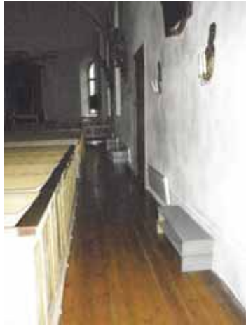
Figur 22. Äldre radiatorer på västra väggen.
