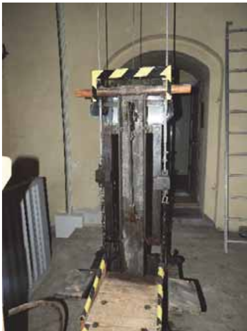
Figur 87. Ringverket före åtgärder.
