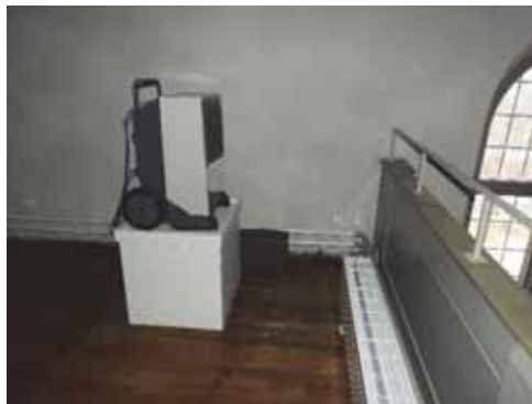
Figur 36. Podium för avfuktare placerad på läktarens östra sida.
