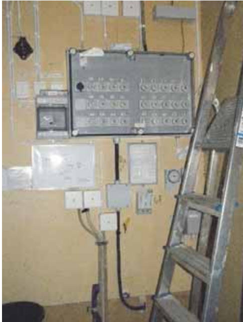
Figur 38. Tidigare elcentral i skrub i vapenhuset.
