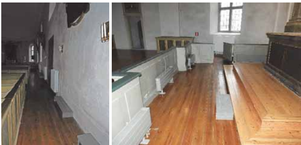
Figur 30. Nya konvektorer på långhusets västra sida.
