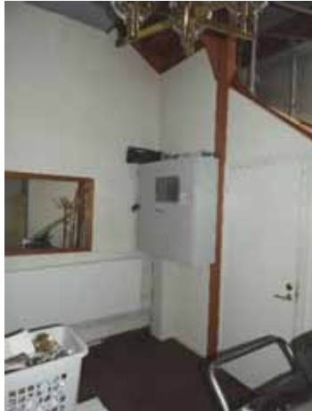
Figur 40. Styrskåp i Kapprum efter åtgärder.
