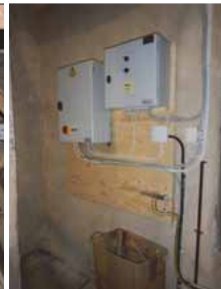
Figur 92. Installationer för elektrisk klockringning. Foto: Svensk Klimatstyrning.
