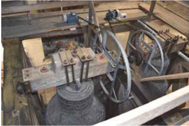
Figur 95. Monterad elektrisk klockringning. Foto: Svensk Klimatstyrning.
