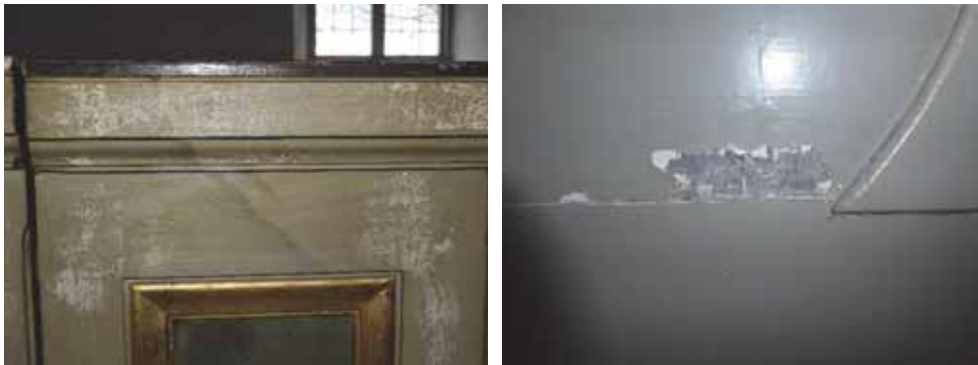
Figur 20. Den befintliga uppvärmningen har bidragit till torkskador och färgsläpp på snickerier. Exempel på skador på södra bänkkvarteret.
