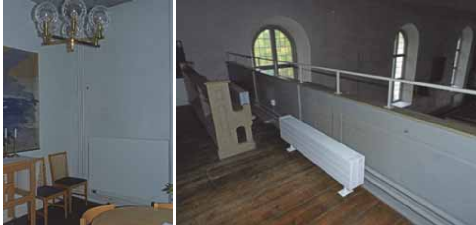
Figur 34. Ny konvektor och synliga rör i den västra läktarunderbyggnaden. I detta läge skulle ingreppen blivit mer omfattande om man valt att förlägga rören dolt.
