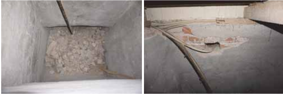
Figur 16. Äldre schakt för värmekulvert till sakristian med s.k. EDIL-kabel, före åtgärder. Foto: Tobias Mårud.
