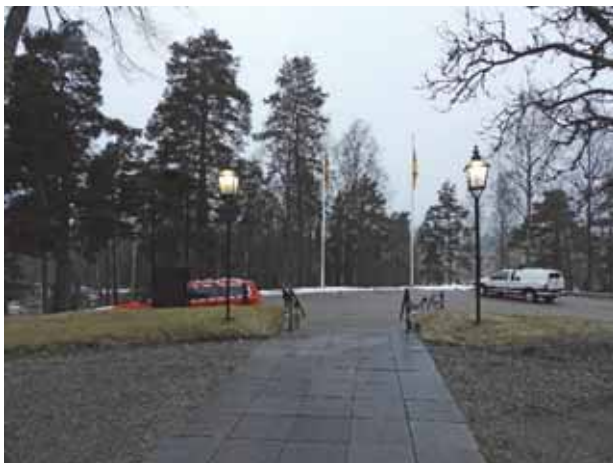
Figur 50. Befintliga lyktor är kvar men har fått utbytt elkablage och ljuskälla.
