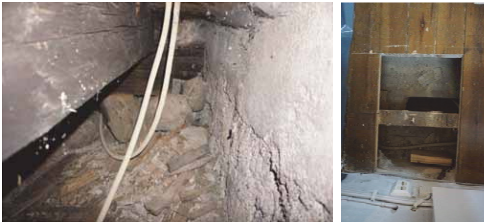
Figur 18. Befintliga elkablar under golvet i koret. Observera att putsen på väggen går ned en bit under golvnivån. Foto: Tobias Mårud.
