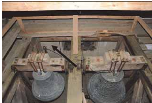
Figur 91. Plats för utrustning före installation.
