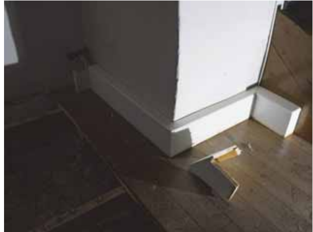
Figur 41. Befintlig kabellåda i sakristia utnyttjades för tillkommande installationer. Foto: Tobias Mårud.
